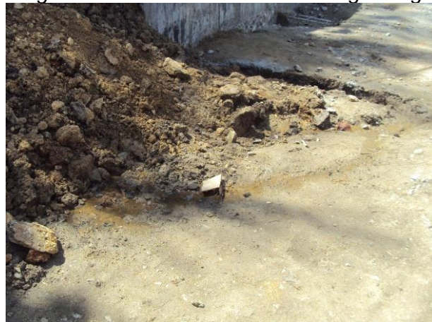
Ilustración 22 Lugar de las excavaciones donde llega el agua de filtración
