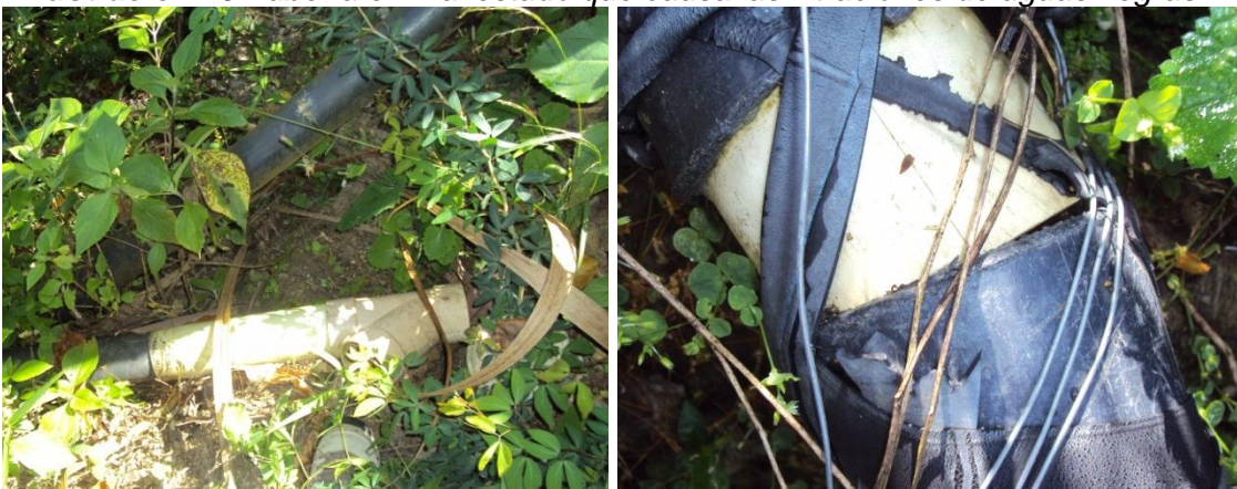
Ilustración 19 Tubería en mal estado que causa las filtraciones de aguas negras
