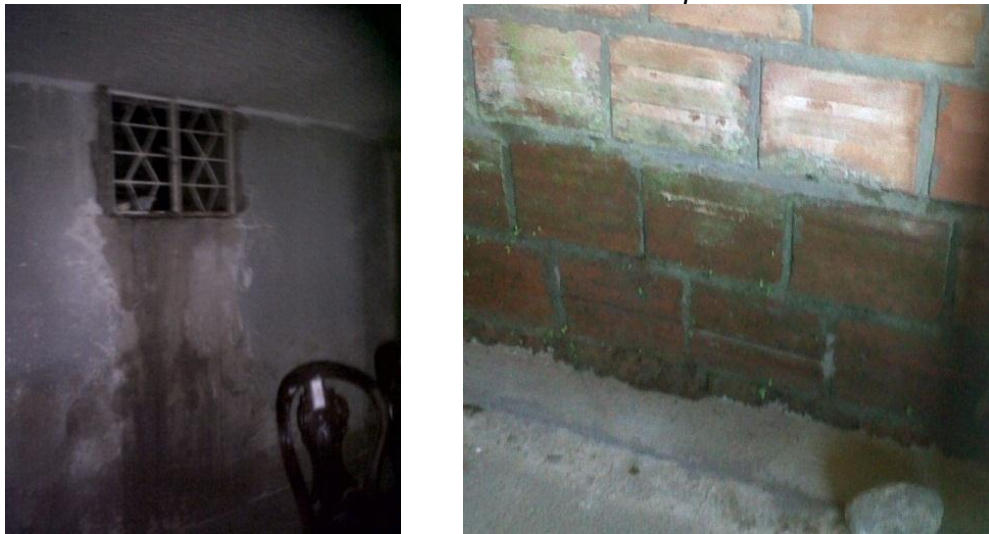
Ilustración 14 Interior de la casa afectada por filtraciones
