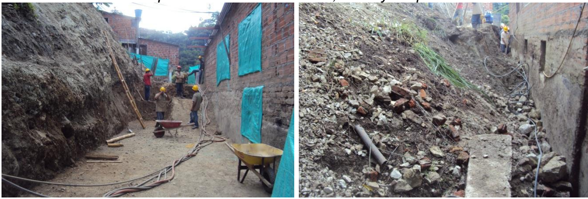
Ilustración 37 Comparativo del sitio excavado, antes y después de los derrumbes
