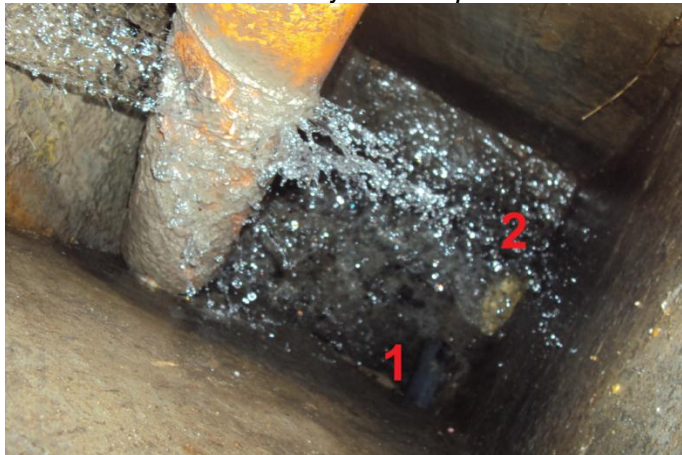
Ilustración 20 Tubería de Cajas de inspección en mal estado
