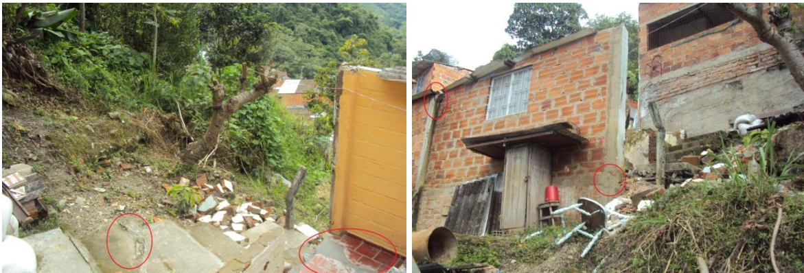
Ilustración 17 Descripción de los daños que tienen las casa de las señora Esperanza Portilla
