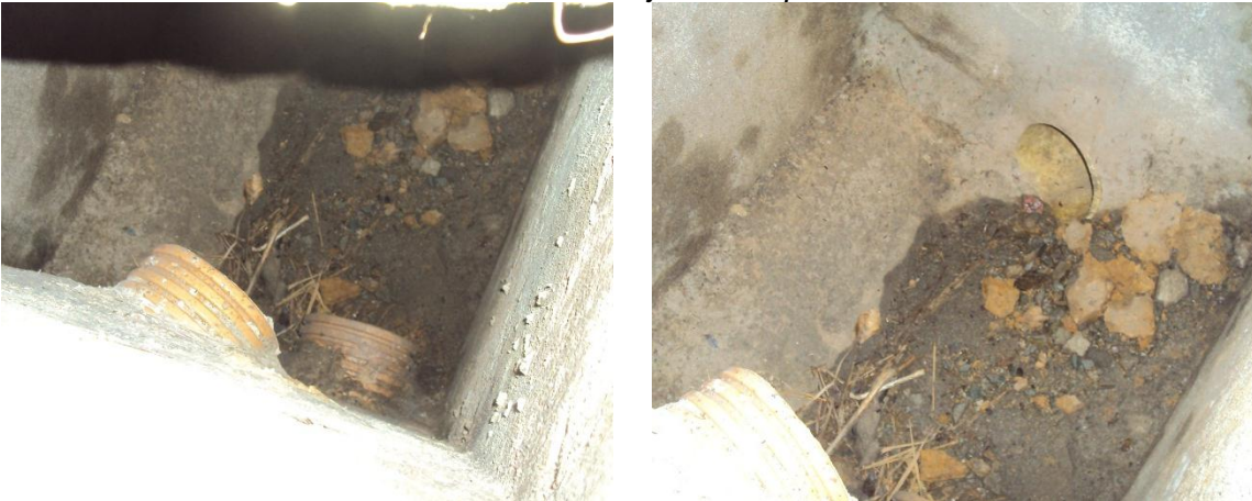
Ilustración 21 Interior de las cajas de inspección en mal estado
