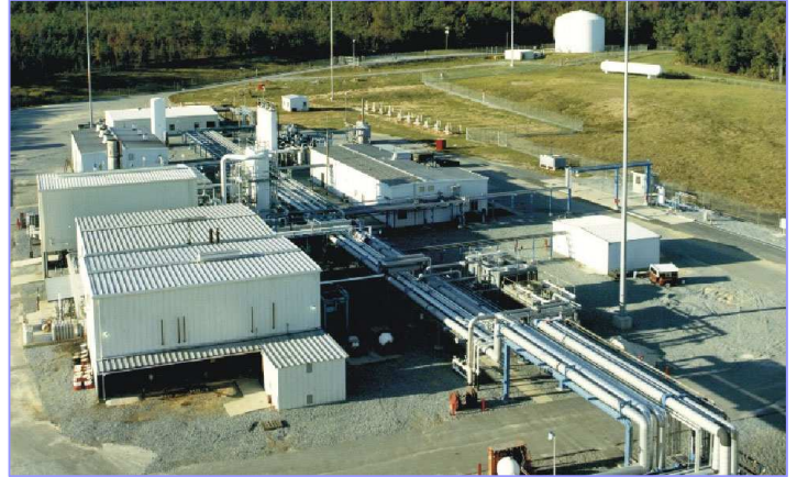
Tanques con bomba de transvase y medición criogénica
