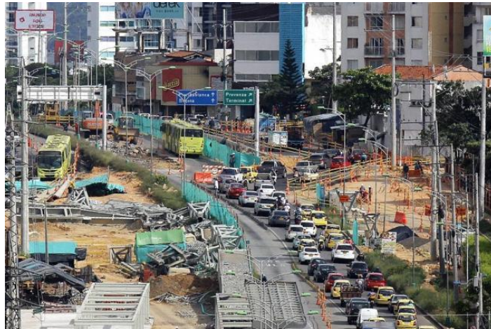
Figura 2. Colapso vial producido por obras del tercer carril.
