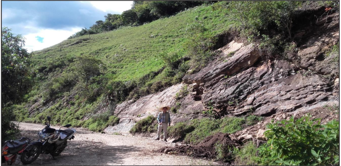
Figura 47. Deslizamiento traslacional planar, observado en la vía que conduce del casco urbano del Municipio de Macaravita a la vereda El Juncal, del Municipio de Macaravita. Fotografía tomada en las coordenadas: E: 1.164.415, N: 1.210.188, en dirección N15°E.
