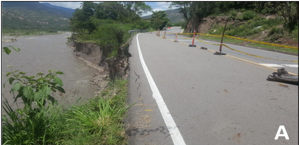
Figura 44. A. Movimiento en masa de tipo caída de detritos, registrado sobre la vía Capitanejo – Tipacoque, al margen izquierdo del río Chicamocha, afectando 100 m de la vía. Foto tomada en las coordenadas: E: 1.153.840, N: 1.210.614, en dirección S10°W. B. Movimiento en masa de tipo volcamiento y caída de detritos, observado a 20 m de la vía principal del casco urbano del Municipio de Capitanejo, al margen derecho del río Chicamocha, registrado en las coordenadas: E: 1.153.106, N: 1.212.120.
