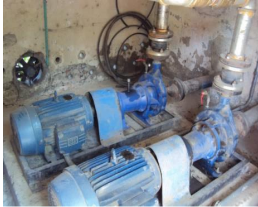
Figura 8: Fotografía bombas de impulsión.
