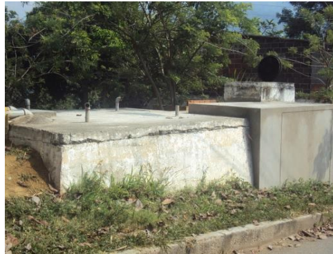
Figura 5: Fotografía tanque de succión.
