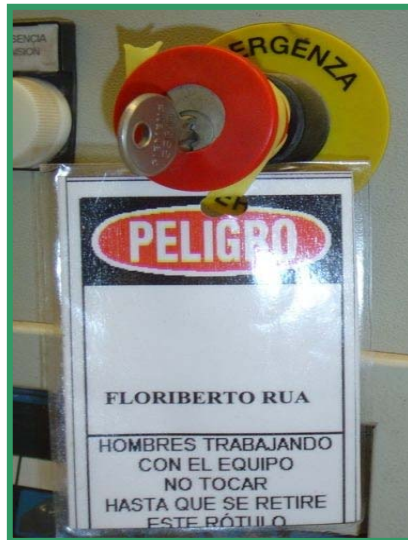
Figura 84. Ejemplo bloqueo y candadoo de un sistema de alimentación eléctrica
