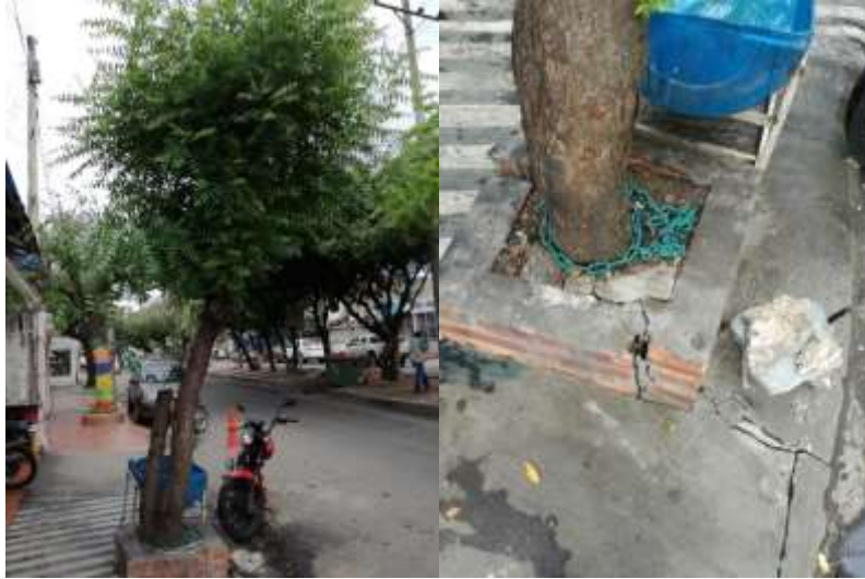
Imagen 3. Árbol de Azadirachta indica A.Juss. (neem) autorizado para tala (Izq.) / Ruptura de pisos ocasionada por el sistema radicular del árbol (Der.)
