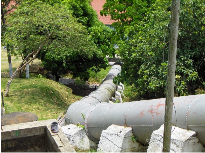
Figura 138: Tubería de presión de la central de Zaragoza
