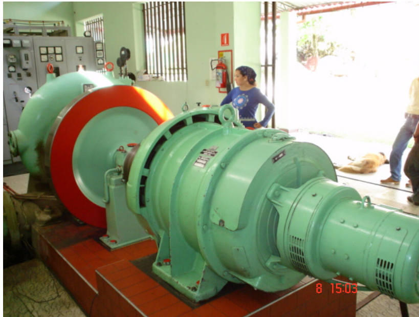
Figura 135: Casa de máquinas de Calichal
