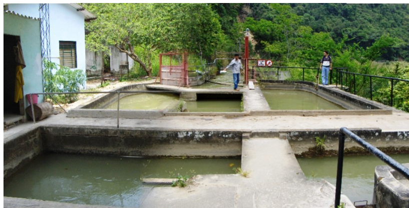
Figura 137: Cámara de presión de la central de Zaragoza
