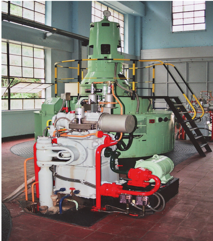
Figura 142: Casa de máquinas de la central de Palmas
