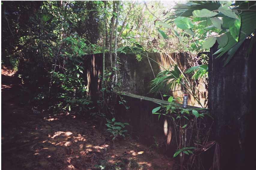
Figura 127: Interior del tanque desarenador
