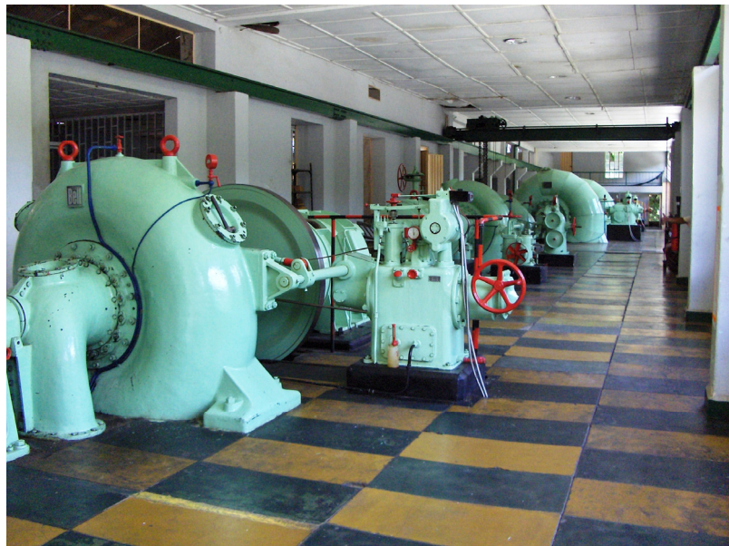
Figura 140: Casa de máquinas de la central La Cascada
