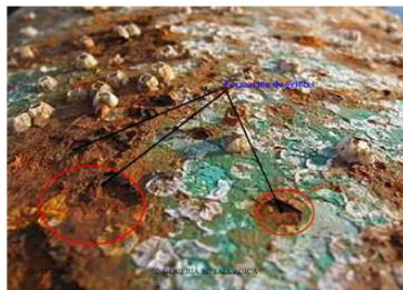
Figura 5 Corrosión biológica o microbiana 2
