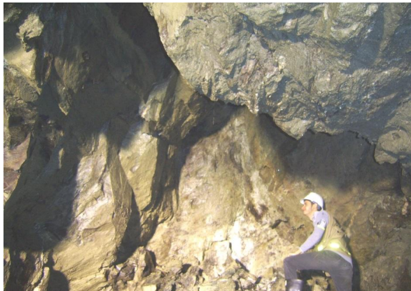
Fotografía 5. Falla de Cuña en la clave del túnel de Aducción.
