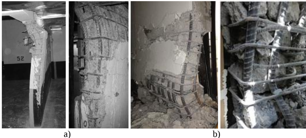
Figura 9. Fallas fuera del plano - a) sismo Chile b) Sismo nueva Zelanda. Fuente: Wallace (2012) y Elwood (2013).
