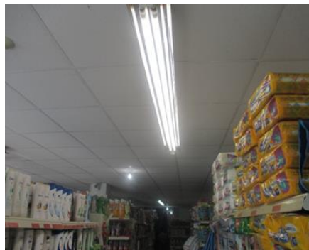
Figura 16. Iluminación artificial, tubo fluorescente, Supermercado CAJASAN San Alberto
