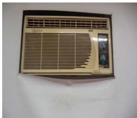
Figura 19. Ventilación artificial. Aire acondicionado obsoleto. Jardín Infantil Sotomayor
