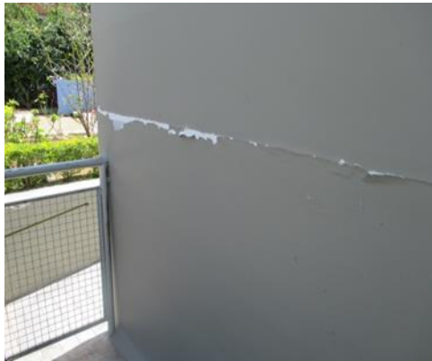
Figura 11. Dilatación de pintura en muro de mampostería liviana. Centro de Desarrollo Infantil CDI
