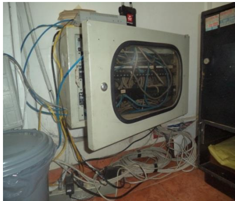
Figura 28. Rack de comunicaciones. Instituto Técnico Laboral Sotomayor
