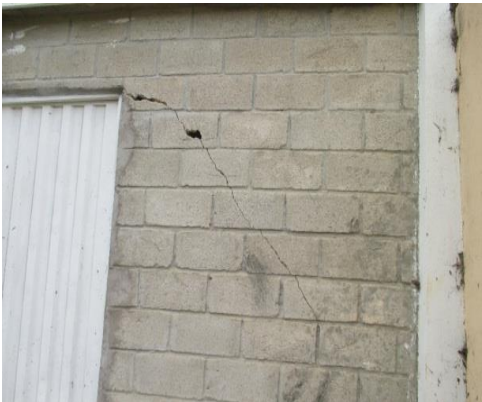
Figura 12. Grieta en muro de ladrillo en cemento hueco a la vista. Jardín Social Luz del Cielo
