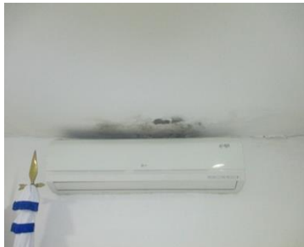
Figura 13. Humedad por proceso de condensación en cielo raso de drywall Centro empresarial Sabana de Torres
