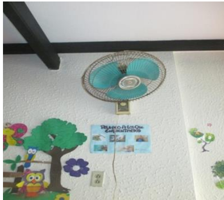
Figura 17. Ventilación artificial, ventiladores Obsoleto. Jardín Infantil Sotomayor
