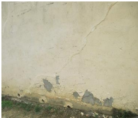
Figura 10. Fisura diagonal en muro de ladrillo en temosa con descascaramiento de pintura. Jardín Social Luz del Cielo
