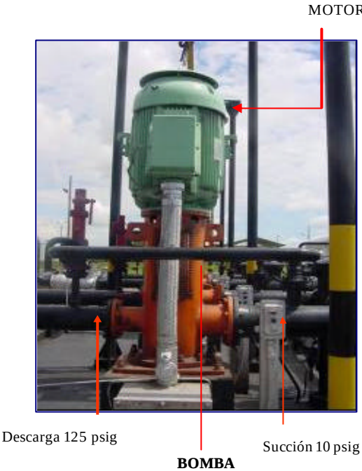
Figura 23. Bombas de refuerzo
