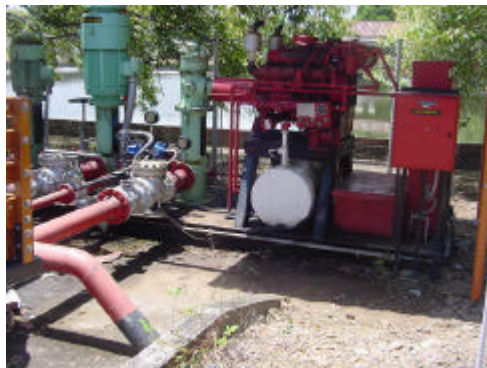
Figura 35 Casa de Bombas Contra incendio Estación de Recolección Apiay
