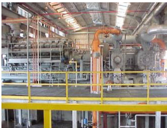
Figura 19. Compresores para el Proceso del Gas
