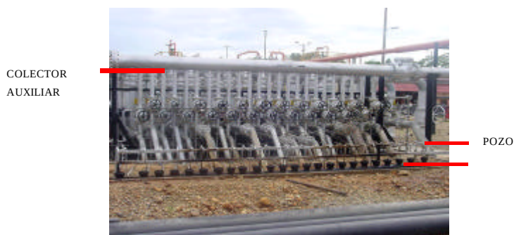
Figura 25. Entrada de pozos al múltiple
