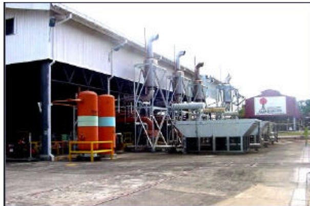
Figura 12. Caseta de los Generadores Refinería Apiay
