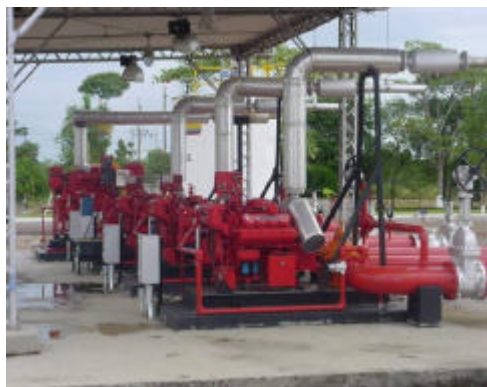
Figura 34. Casa de Bombas Contra incendio Estación de Bombeo
