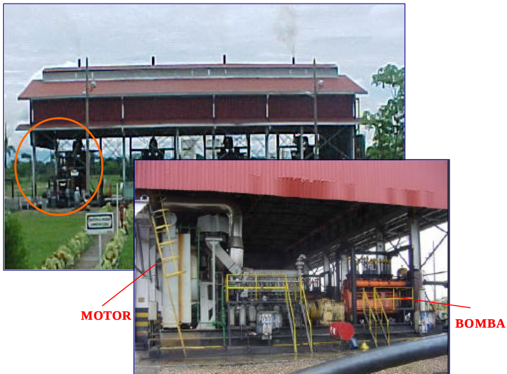
Figura 43. Casa de Bombas Estación de Bombeo Apiay
