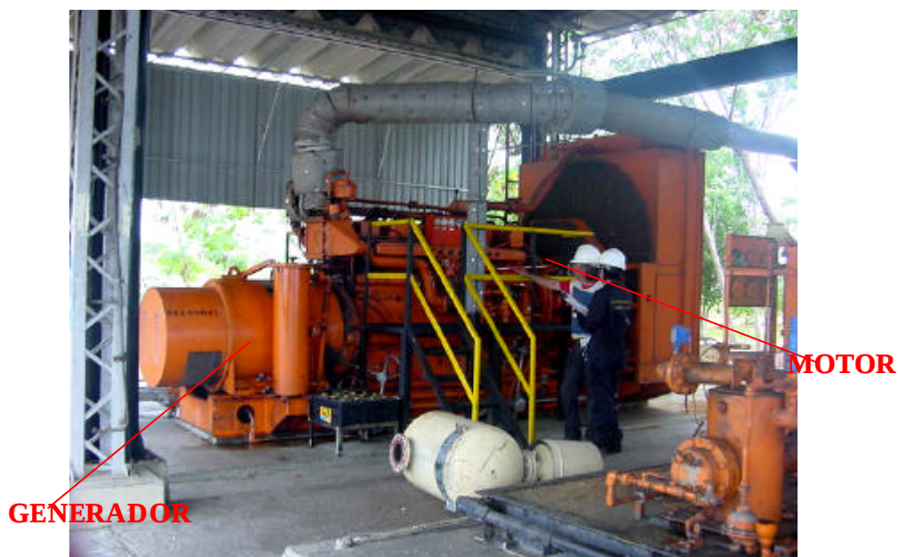
Figura 44. Generador Estación de Bombeo Apiay
