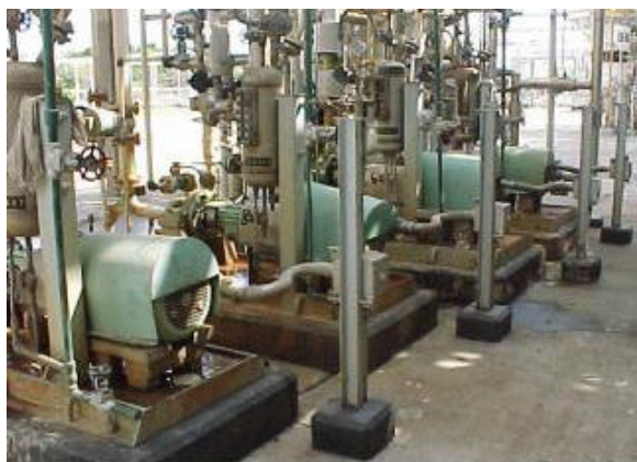
Figura 20. Bombas de planta de gas
