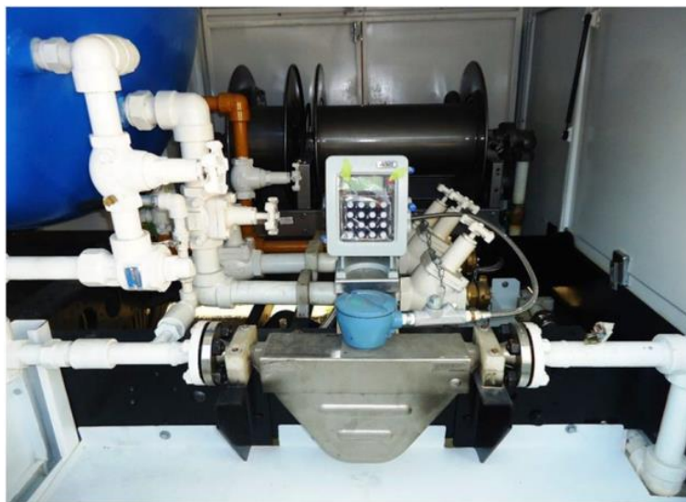
Figura 62. Vista del medidor másico, sistema de adquisición RI-505, sistema hidráulico
