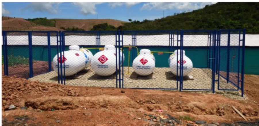
Figura 1. Instalación típica de tanques estacionarios
