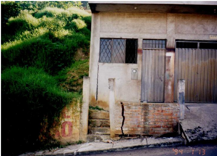
Fotografía B-4- Casas localizadas en la pata del deslizamiento
