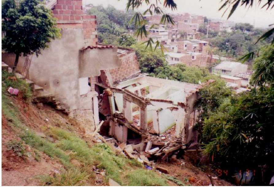
Fotografía B-3- Casas colapsadas, localizadas en el sector medio del deslizamiento
