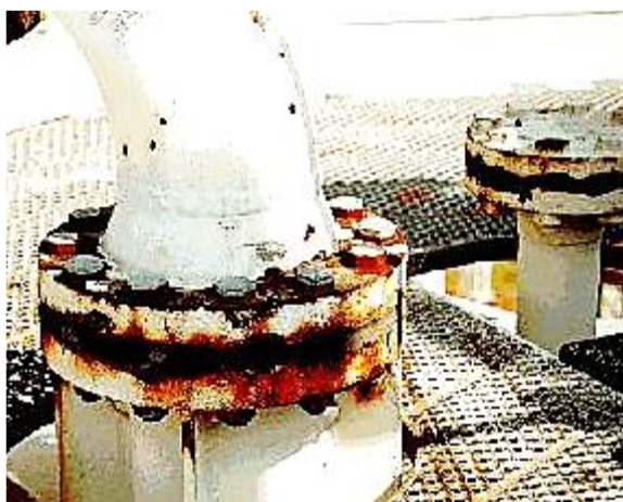
Figura 2. Bridas corroídas por la condición atmosférica
