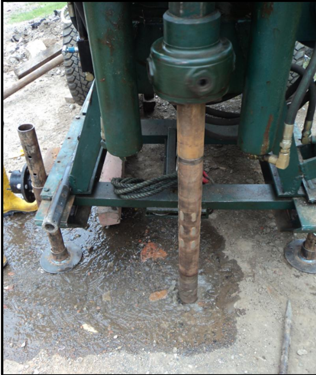
Fuente: Torres Ingeniería S.A.S. – EDARFRI San Vicente de Chucurí[6]
