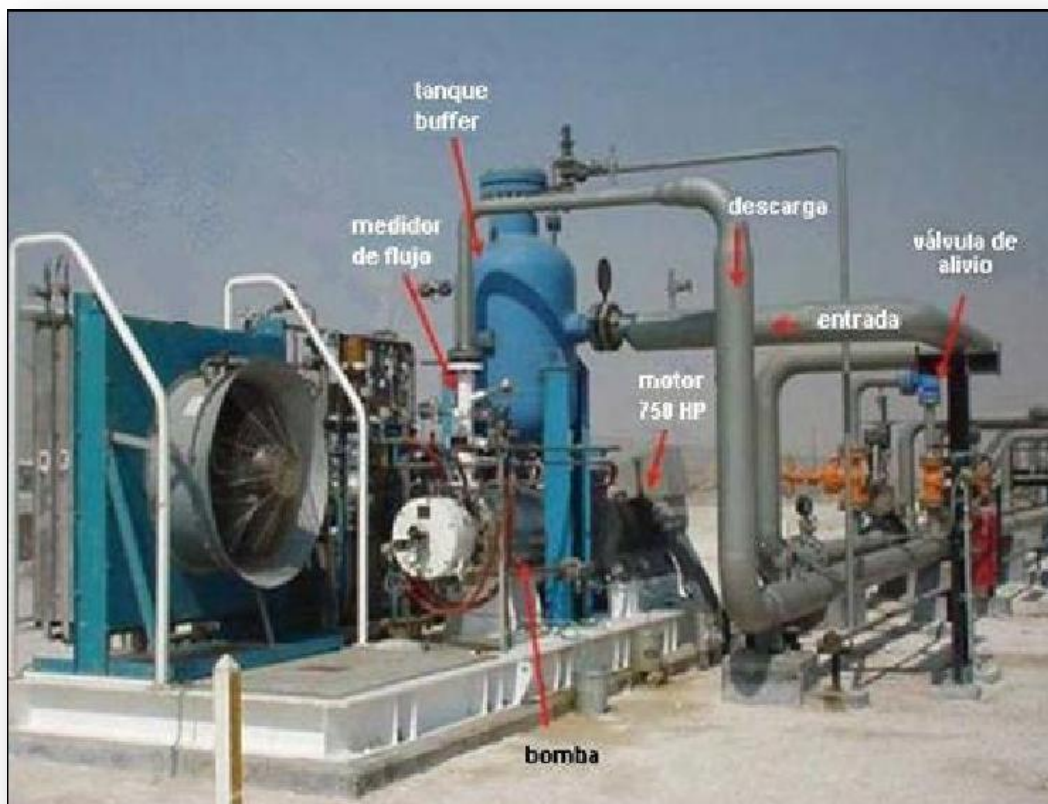
Figura 20. Bomba multifásica en el campo Abquaiq, Arabia Saudita
