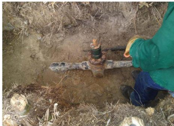
Imagen 8 Válvulas roscadas de corte con por corrosión.
