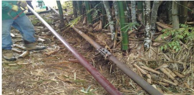
Imagen 4. Daño por corrosión, instalación de sillas para control de fugas.
