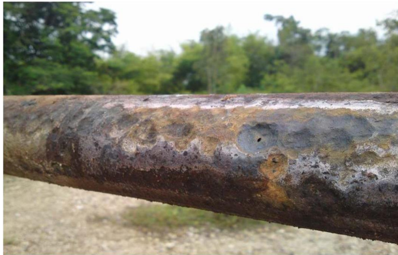
Imagen 3. Daño por corrosión y piteras en tuberías
