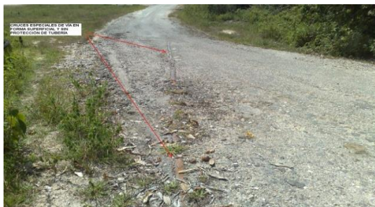
a. Cruces en vías sin protección alguna
