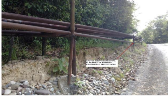
a. Ancho insuficiente para el apoyo de las líneas existentes
