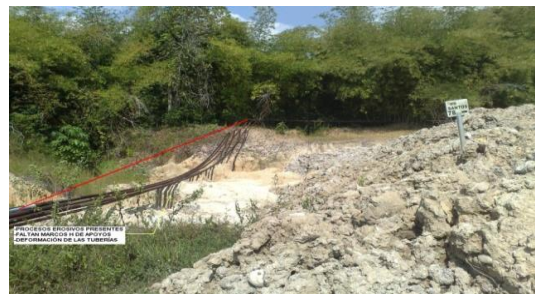
b. Tendido aéreo sin apoyos causa deflexiones en la tubería
