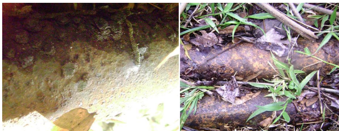
Imagen 9. Corrosión externa e Interna de las líneas de inyección del Campo Provincia
