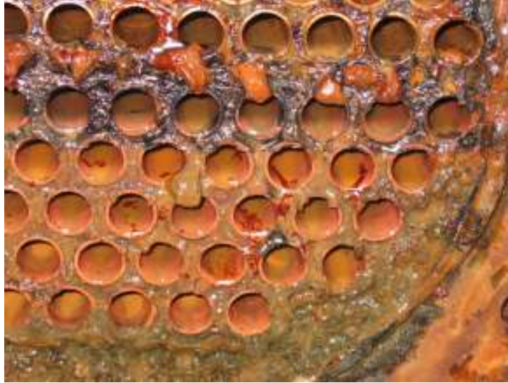
Figura 62. Intercambiador de calor sucio
