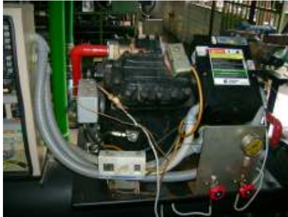
Figura 68. Compresor con falta de manómetro y termómetros
