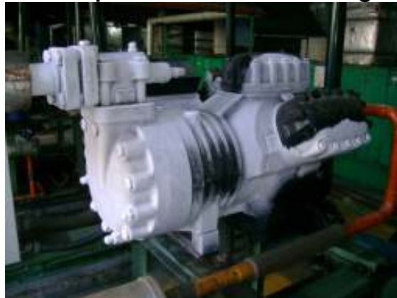
Figura 71. Compresor en estado de congelamiento
