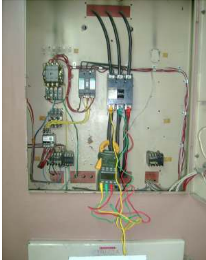
Figura 60. Medida de potencias con el analizador trifásico
