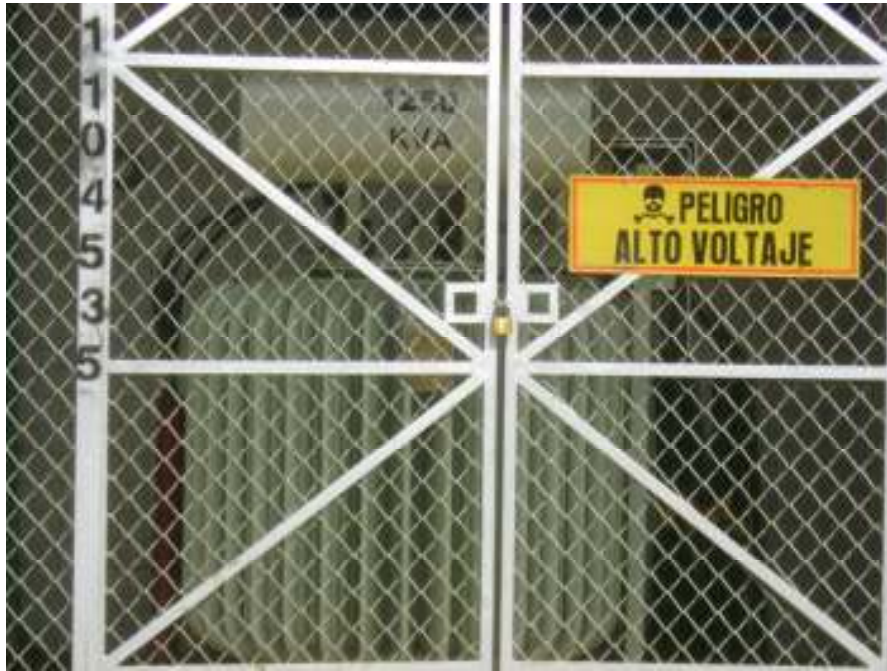
Figura 56. Transformador 1250KVA propiedad del HUS
