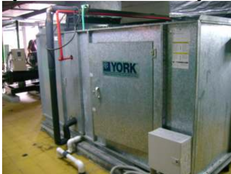
Figura 26. AHU sistema centralizado de urgencias
