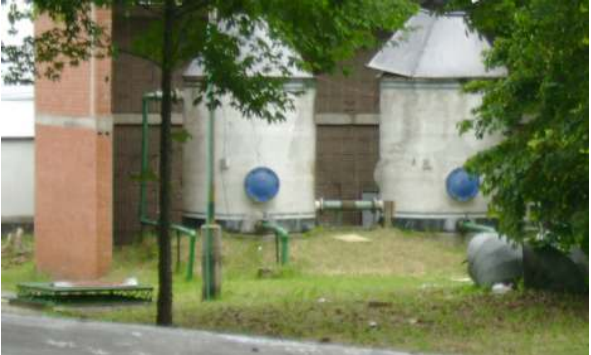
Figura 38. Torres de enfriamiento sistemas centralizados de acondicionamiento de aire HUS
