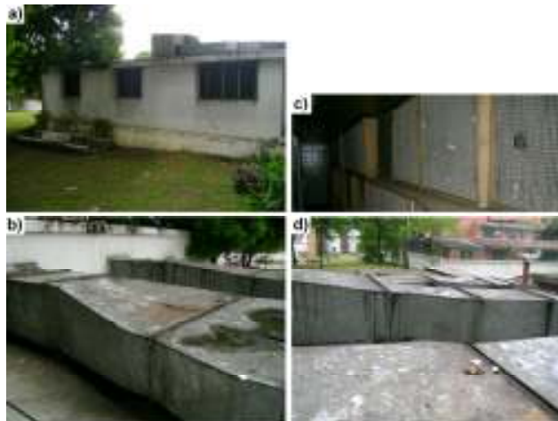
Figura 40. Cuarto de filtros HUS
