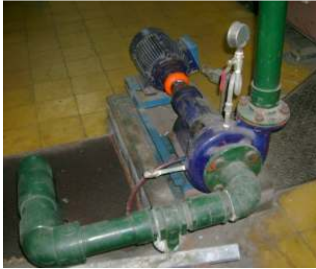
Figura 36. Bomba centrífuga Maternidad
