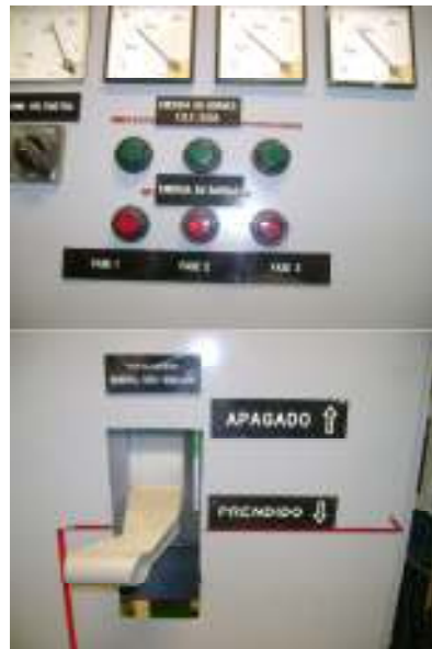
Figura 58. Tablero de control subestación
