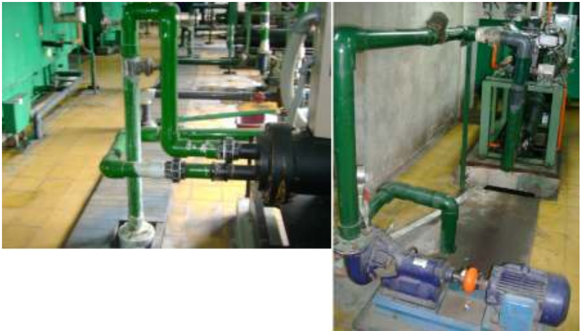
Figura 17. Fotografías del cuarto de máquinas
