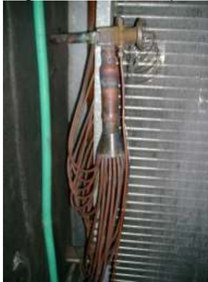
Figura 23. Fotografía válvula de expansión urgencias
