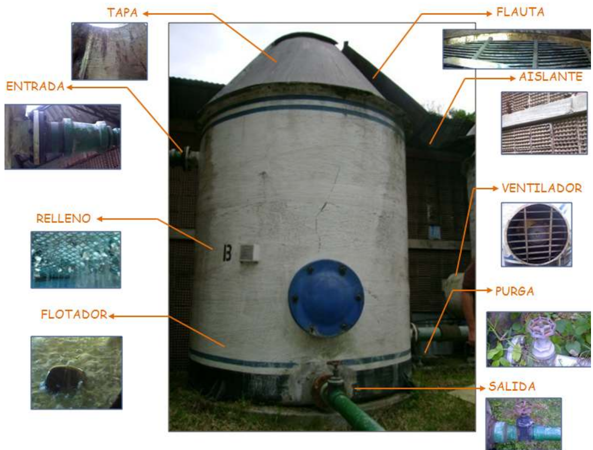
Figura 39. Elementos de la torre de enfriamiento
