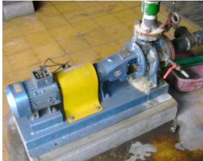
Figura 27. Bomba centrífuga urgencias
