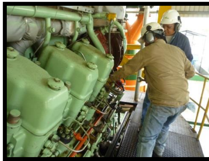
Figura 3. Mtto. Correctivo. Cambio de tubería de alta de combustible de la unidad
