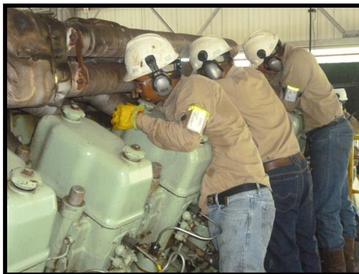
Figura 4. Mtto. Preventivo de 6.000 hrs. Unidad de bombeo.
