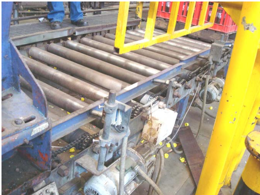
Figura 51. Transportador de Estibas de una Paletizadora
