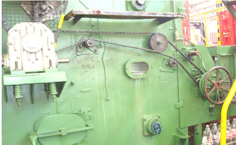
Figura 45. Sistema Motriz del Cargue de la Lavadora de Botellas Austral
