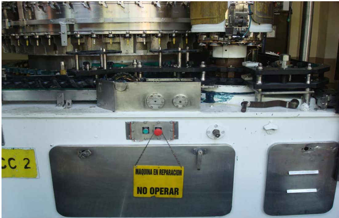
Figura 25. Aviso de Seguridad Equipo en Mantenimiento
