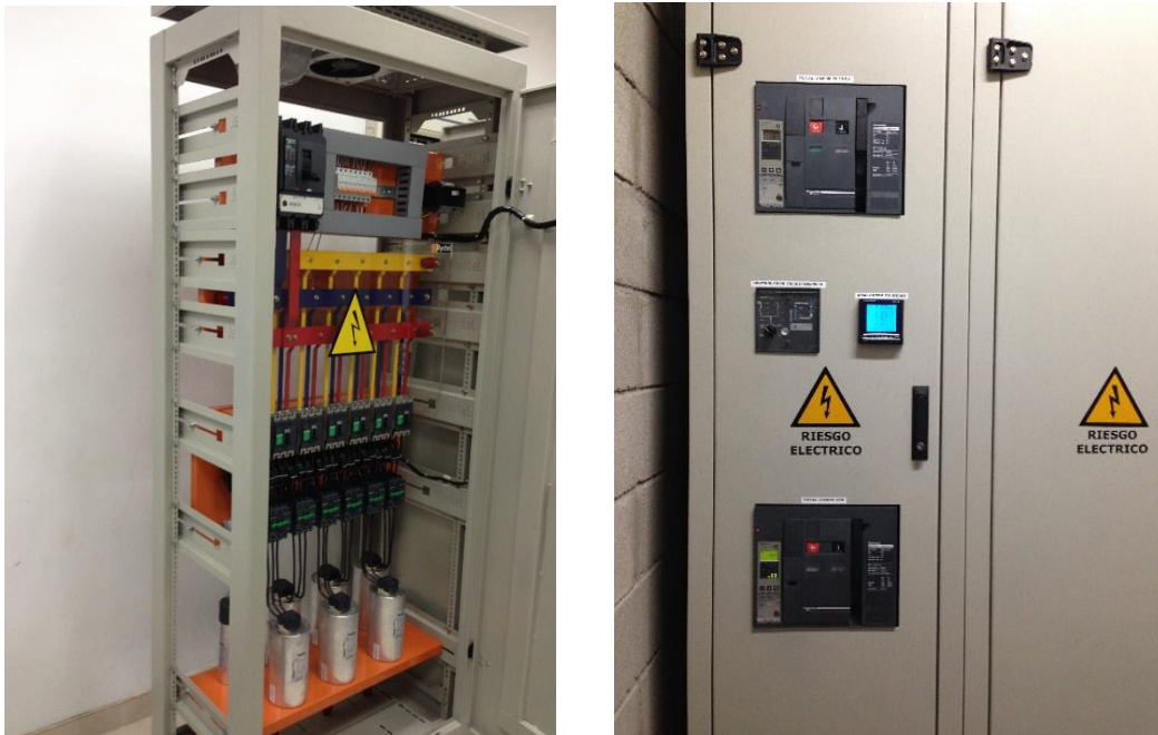
Figura 4. Envolventes actuales de tablero auto soportado Rycltel Ltda
