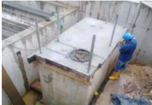
Figura 19. Caja de bombas miniptar Villarosa
