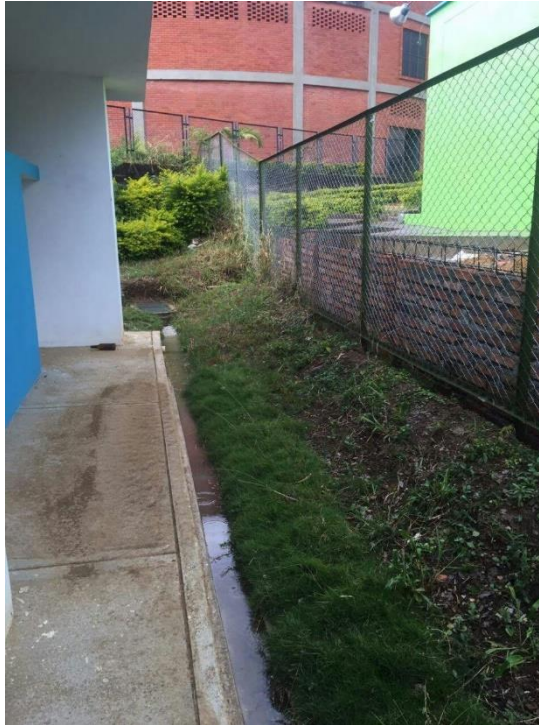
Figura 2. CDI San Gil, Problemas alcantarillado pluvial.
