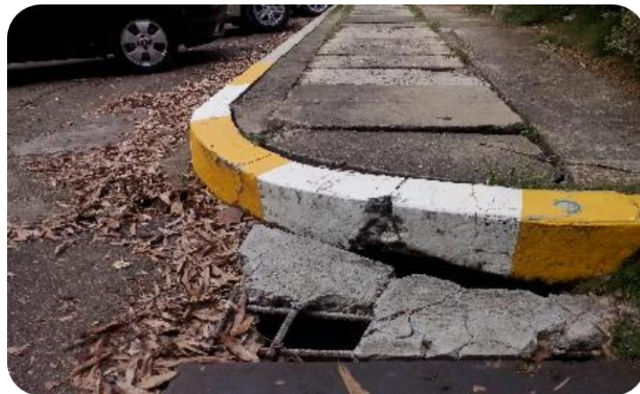
Figura 6. Daño en andenes, zona de parqueo 7.
