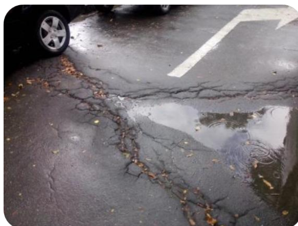
Figura 7. Falla transversal en el pavimento, zona de parqueo 6.
