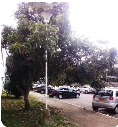
Figura 4. Luminaria obstruida por vegetación, zona de parqueo 7.
