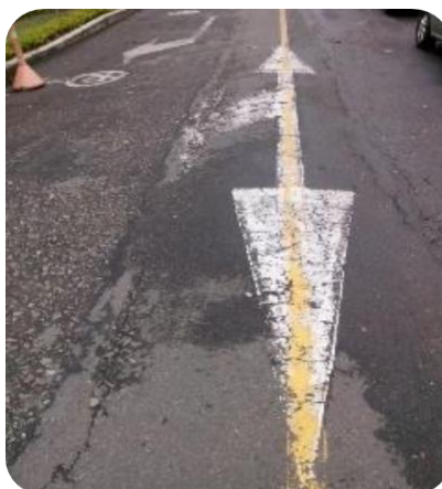
Figura 5. Señalización horizontal deteriorada y mal ubicada. Vía de acceso, zona de parqueo 5.
