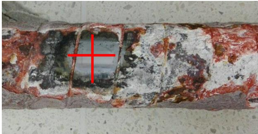
Figura 5. Fotografía del área utilizada para la técnica de inspección por medio de réplicas metalográficas y metalografía tradicional en el tubo de la caldera de Avidesa Mac-pollo fabricado de acero ASTM A192.
