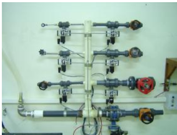
Figura 86 Arreglo de válvulas
