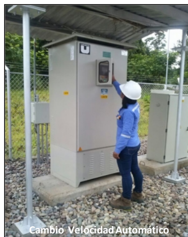
Figura 8. Cambio de velocidad con VFD
