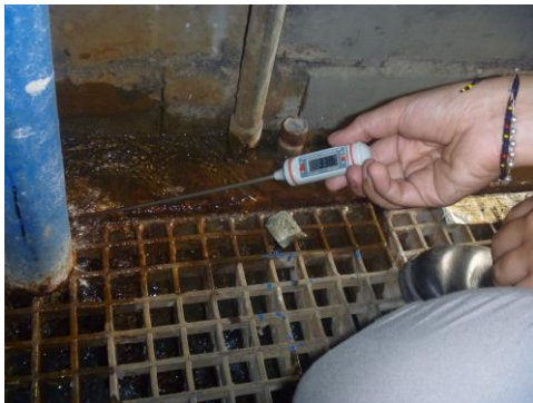
Figura 6. Toma de temperatura de agua suavizada
