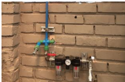
Figura 38. Líneas de Aire Comprimido con salida de \frac{1}{2} " y \frac{3}{4} " con su respectiva FRL
