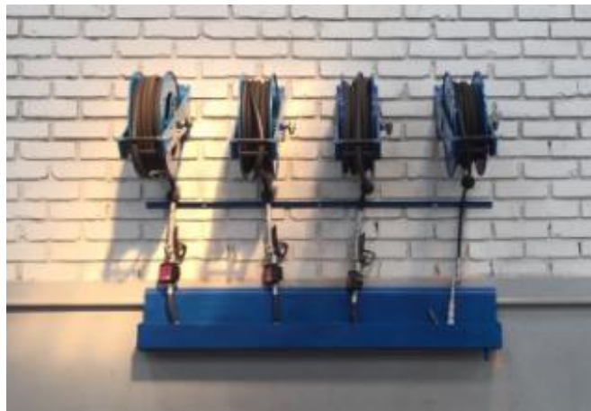
Figura 36. Equipos de Suministro de Lubricantes Bodega 6
