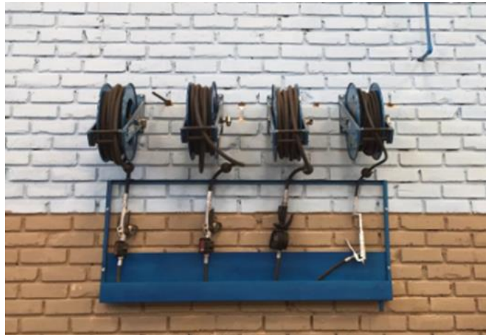
Figura 35. Equipos de Suministro de Lubricantes Bodega 7
