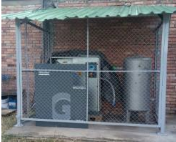
Figura 37. Compresor de Tornillo de 30 CFM
