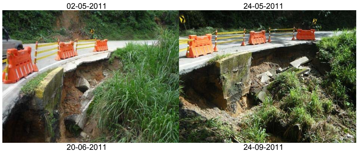
Fotografía 5. Análisis temporal del avance del problema geotécnico, hasta la construcción de la obra.
