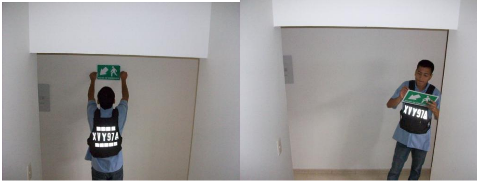
Imagen 7. Señalización en la estación de servicio Aranzoque.
