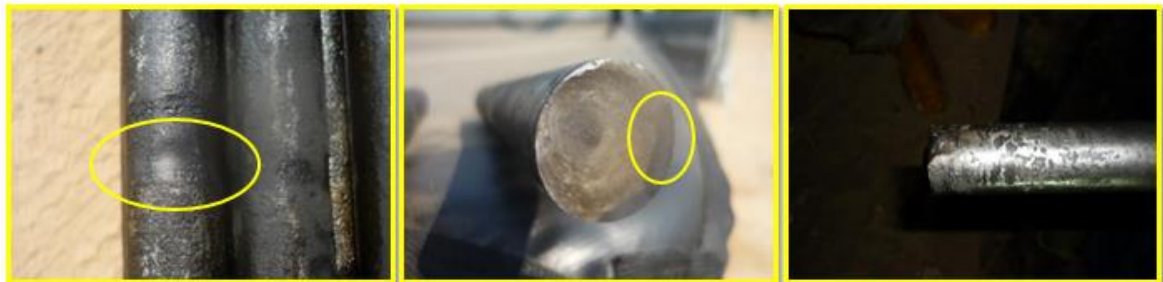
Figura 12. Falla de Varilla partida por fátiga de material debido a corrosión.
