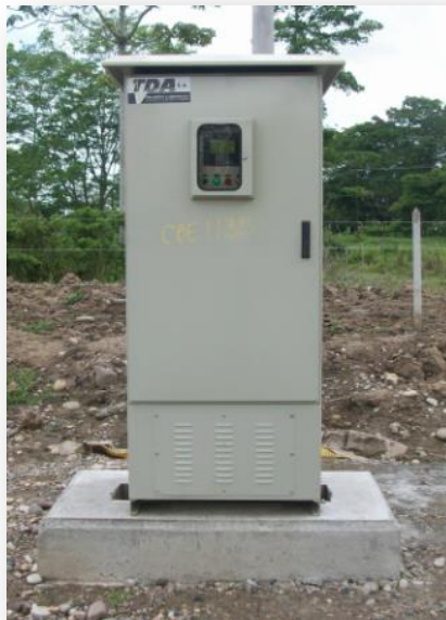
Figura 4. Variadores de Frecuencia.
