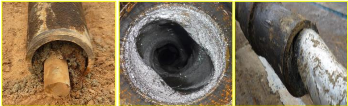
Figura 15. Presencia de arena en sistemas PCP.
