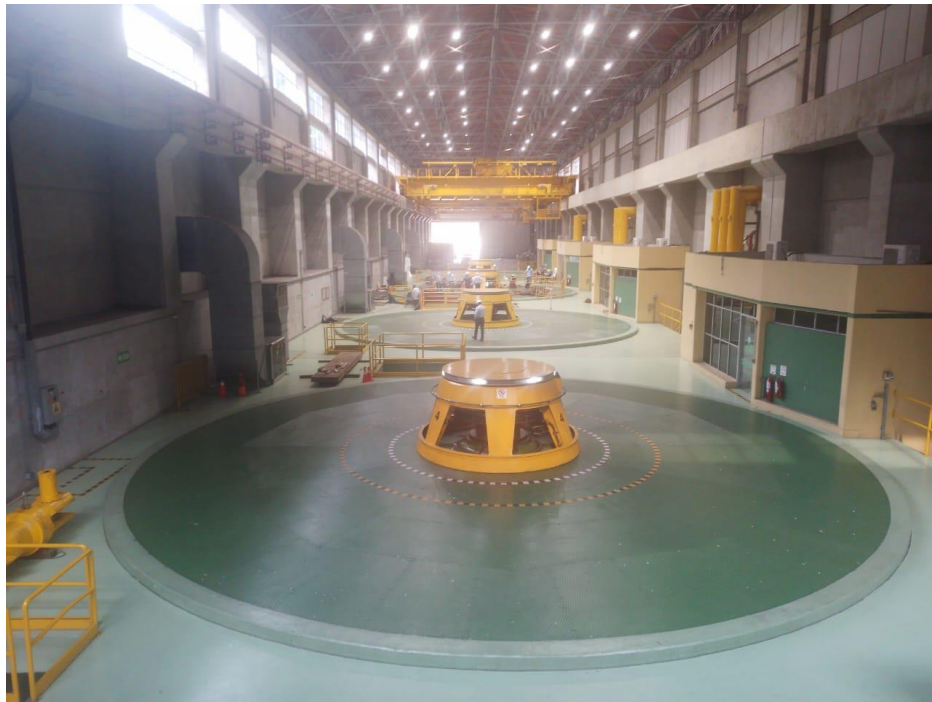
Figura 1: casa de máquinas C.H. URRÁ I
