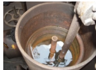
Figura 8. Fotografía del estado actual del sistema de enfriamiento de nafta pesada T-150.
