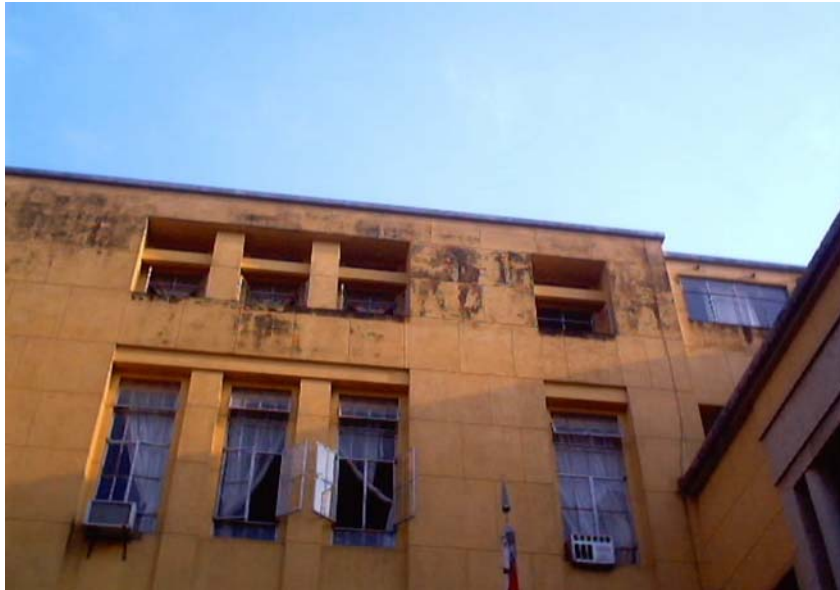
Figura No. 3 Evaluación Fachada Interna, Gobernación de Santander
