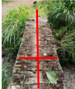
Figura 15. Estado del puente antes de la intervención
