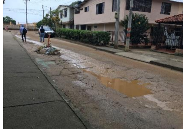
Figura 11. Deterioro del pavimento.
