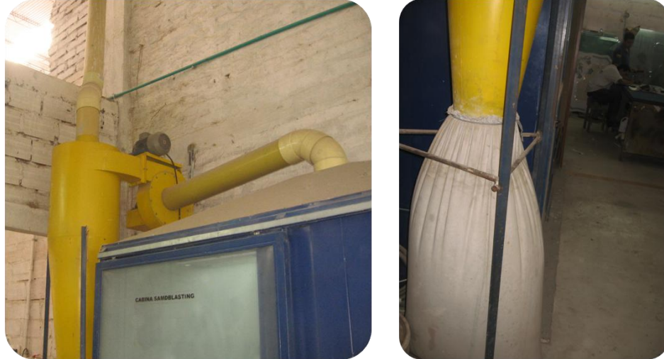
Figura 29. Sistema de extracción de residuos cabina de tallado
