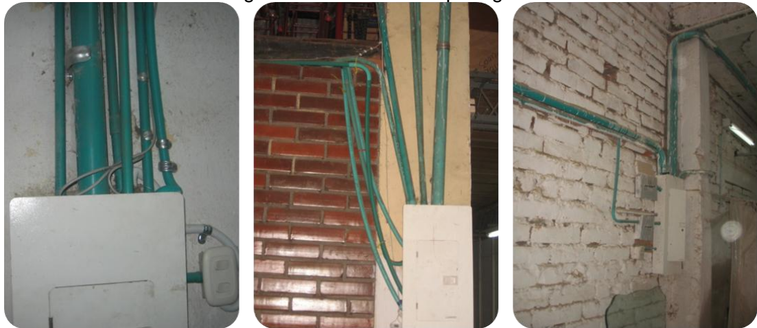
Figura 30. Red eléctrica protegida
