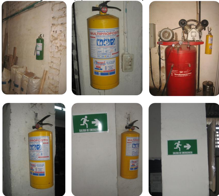
Figura 26. Equipo contra incendios y señalización.
