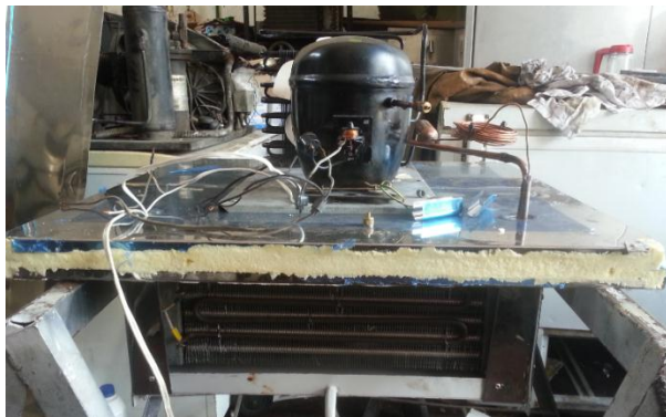
Figura 34. Unidad Condensadora. Fuente: Autores.
