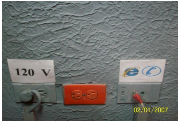
Figura 17. Inspecciones de instalaciones electricas
