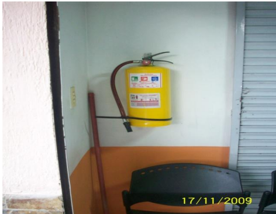
Figura 16. Inspecciones a extintores
