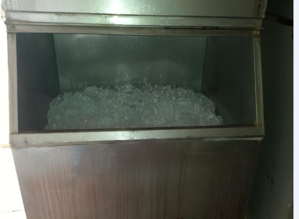
Figura 11. Deposito acumulador de hielo.
