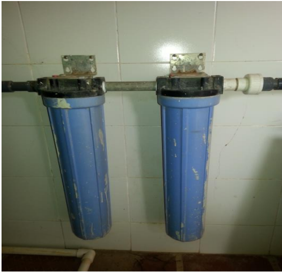
Figura 22. Filtros purificadores de agua.
