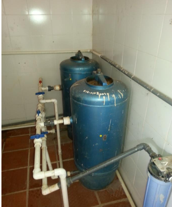
Figura 21. Tanques filtrantes de agua.
