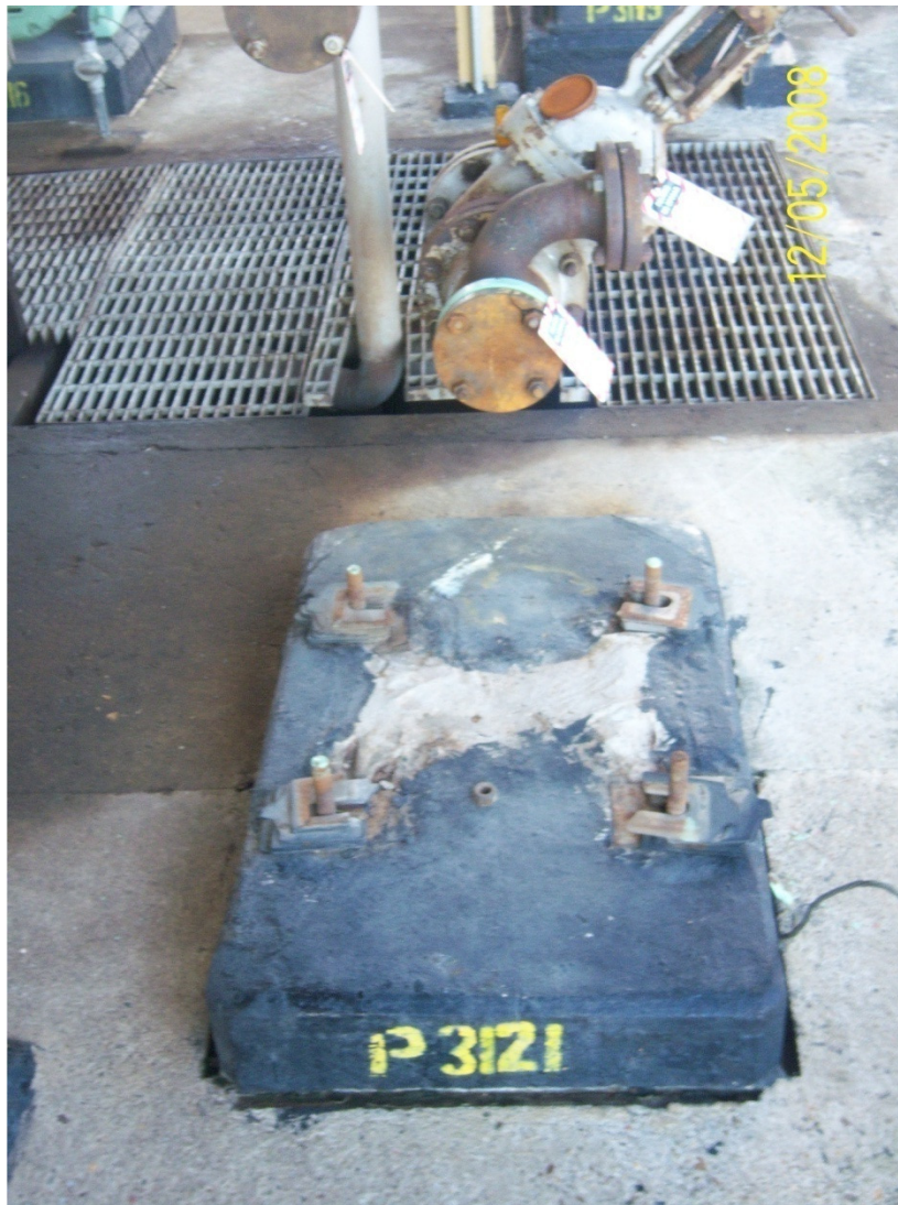
Foto 11. Desmantelamiento de la Bomba p-3121 y aplicación del SAS(Sistema de Aislamiento Seguro)
