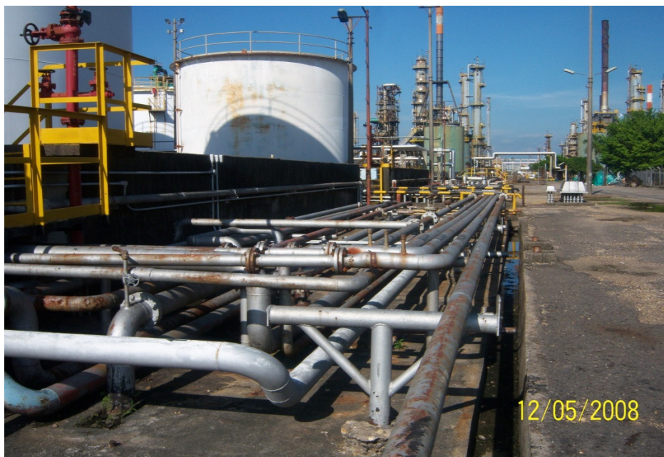
Foto 12. Líneas de descarga hacia el Llenadero.
