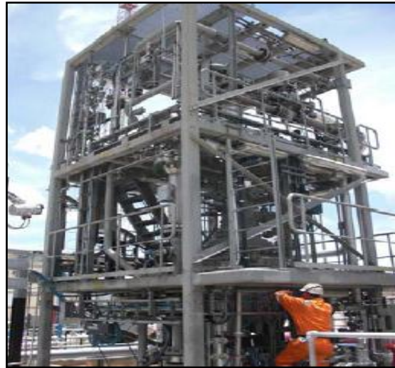
Figura 4. Facilidades del dispositivo Twister en Manatí, una locación Onshore en Brasil.
