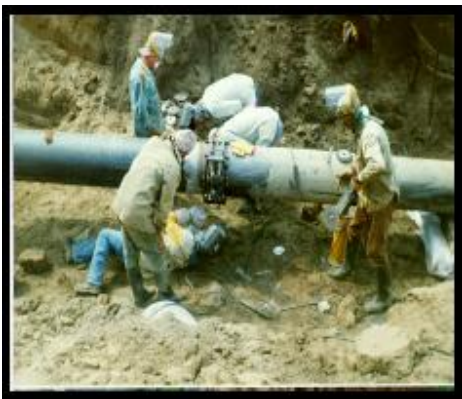
Figura 13. Tramo reparado con grapa
