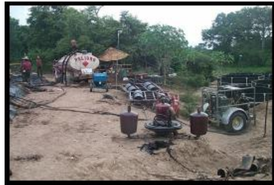
Figura 6. Adecuación de Equipos
