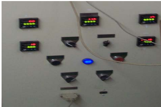
Figura G.1. Panel de control del rectificador de ondas pulsantes.
