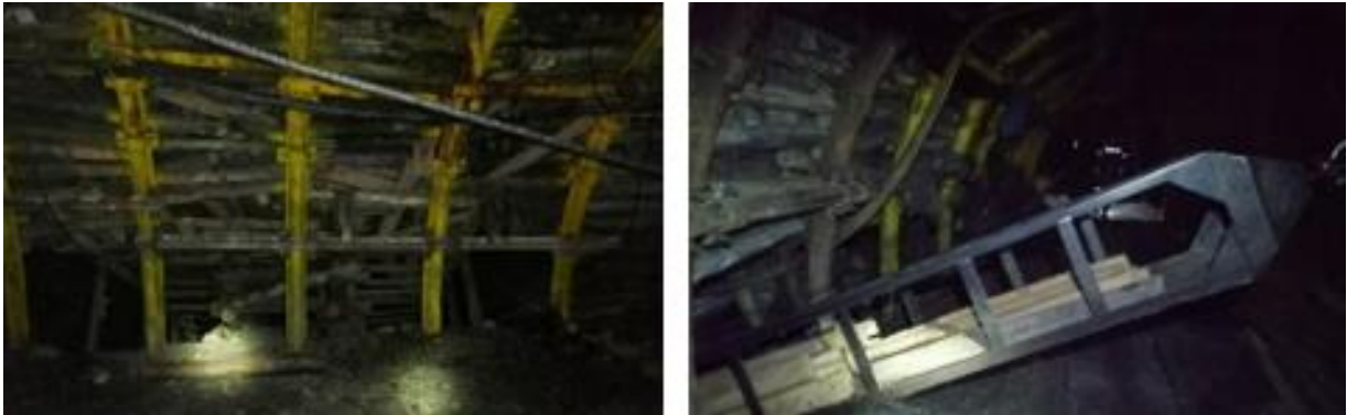
Figura 39. (a) Amarre de arcos nivel sup. (b) Suministro de madera al nivel superior.
