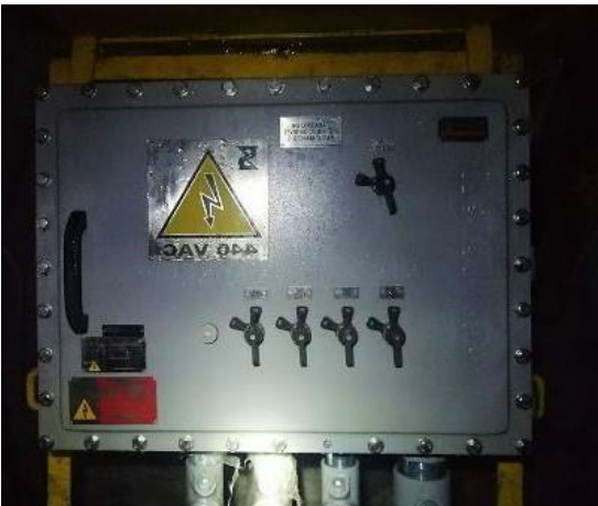
Figura 9. Tablero de distribución.
