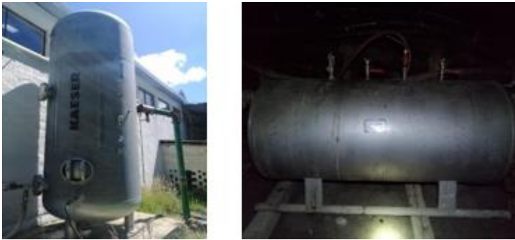
Figura 24. Pulmones de aire comprimido del nivel del patio.
