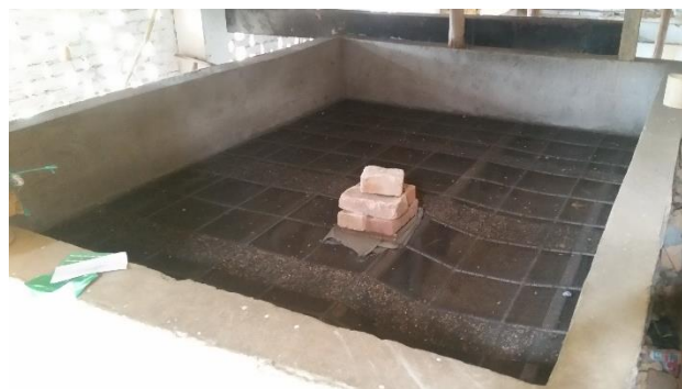
Cámara auxiliar y ducto obstruido con ladrillos.
