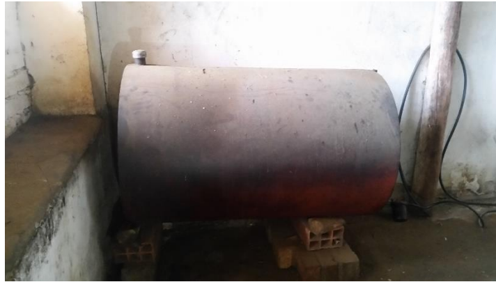
Tanque de almacenamiento del combustible
