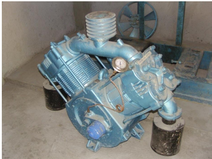
Figura 153. Mantenimiento general compresor BETICO
