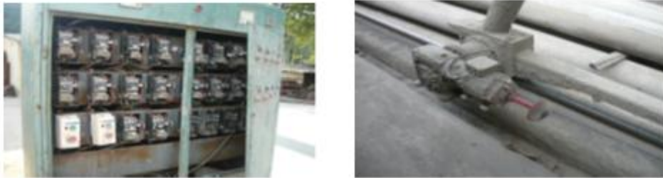
Figura 30. Estado general de los equipos
