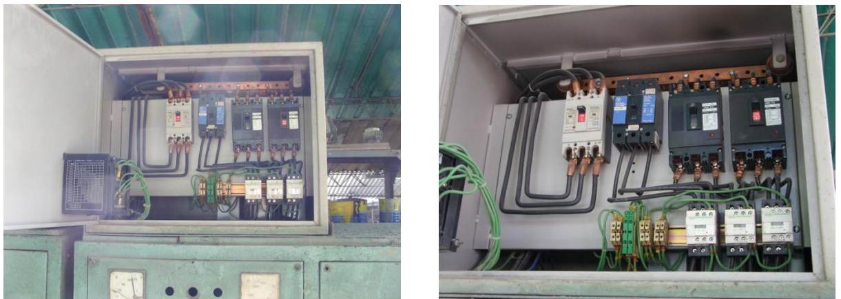
Figura 155. Mantenimiento general Banco de Condensadores
