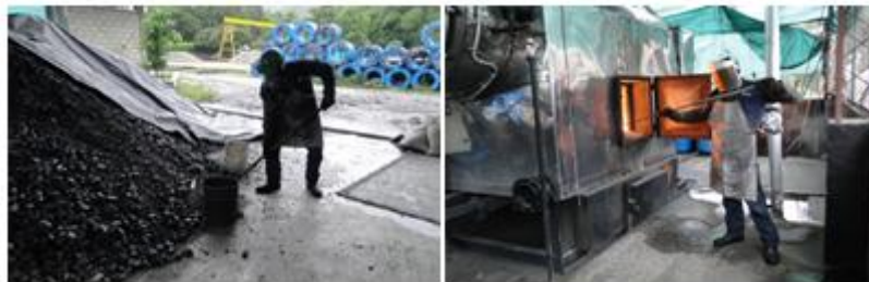
Figura 10. Caldera para la producción de vapor
