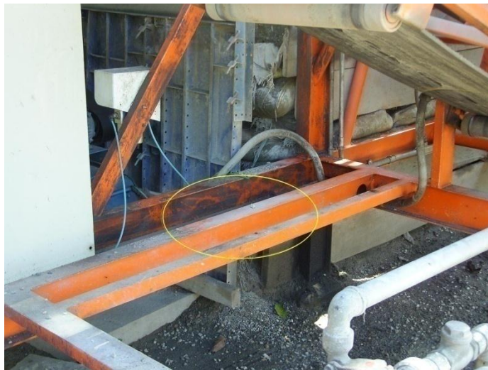
Figura 152. Problemas de vibraciones en la mezcladora Altron. Cambio del compresor de aire y cambio de la ubicación del mismo.
