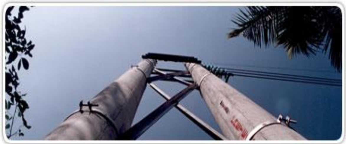
Figura 2. Postes de alta Tensión
